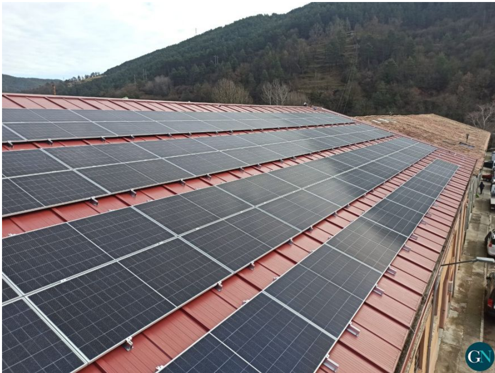
Plaques fotovoltaïques / Aj.Ripoll
