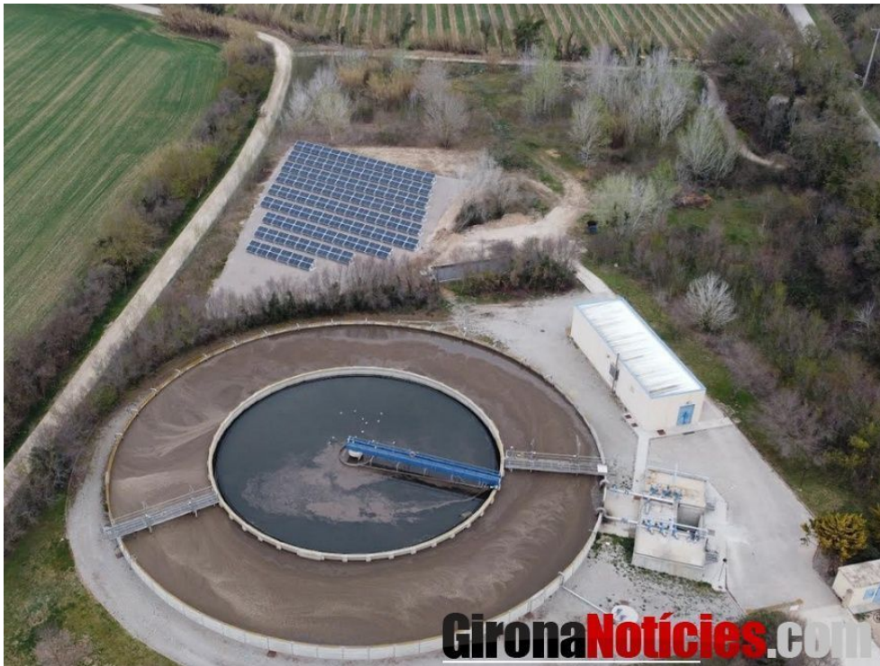
Planta solar fotovoltaica instal·lada a la depuradora de Castelló d'Empúries
