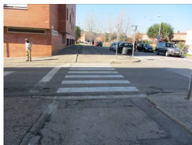
Fotografia 3.2.1.35 – Tram de carril bici amb paviment deteriorat (c/ Valentí Almirall)
