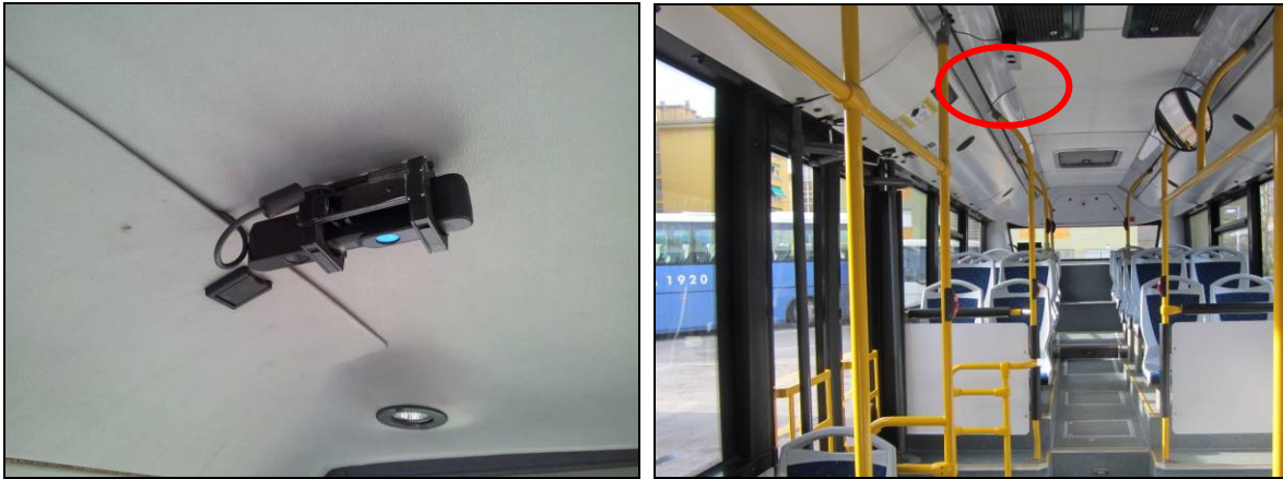
Fotografies 4.4.4.1 i 4.4.4.2 – Imatges de les càmeres instal·lades a bord dels vehicles (a l'esquerra, a la porta d'entrada d'un vehicle de les línies L7 i L11 i a la dreta a la porta de sortida d'un vehicle de les línies L3, L4 i L6)
