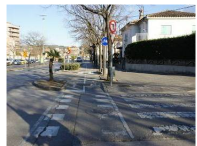
Fotografia 3.2.1.36 – Tram de carril bici amb paviment deteriorat (Pg. d'Olot)
